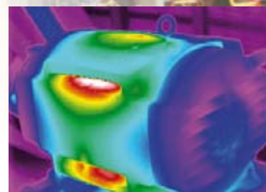
Abnormaal ongelijkmatige verwarming van motor
